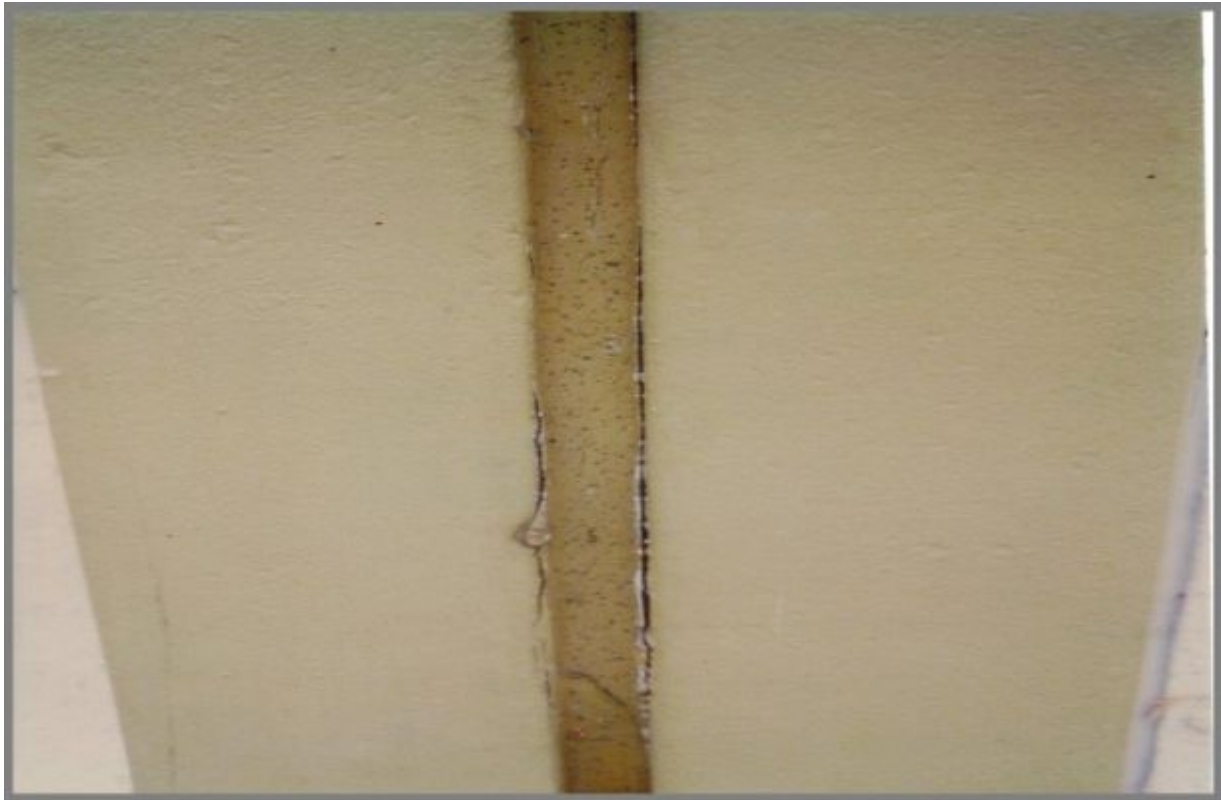
Abbildung 4: Verfärbung eines überstrichenen Dichtstoffs durch Weichmacherwanderung
