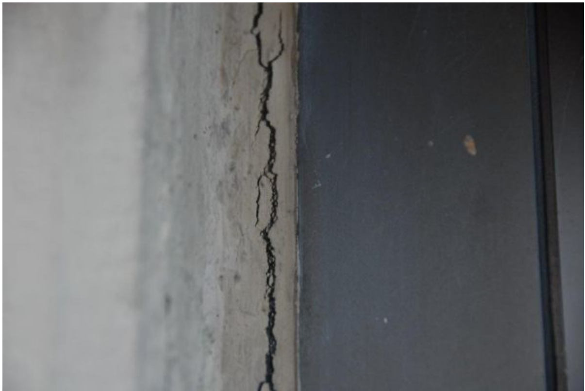
Abbildung 8: Kohäsionsrisse im Dichtstoff durch falsche Fugendimensionierung
