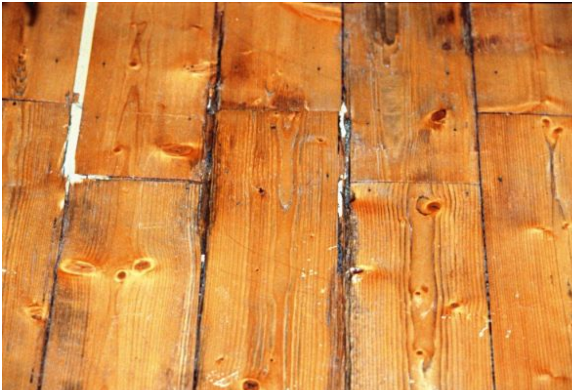
Abbildung 1: Verfugung an nicht maßhaltigen Bauteilen
