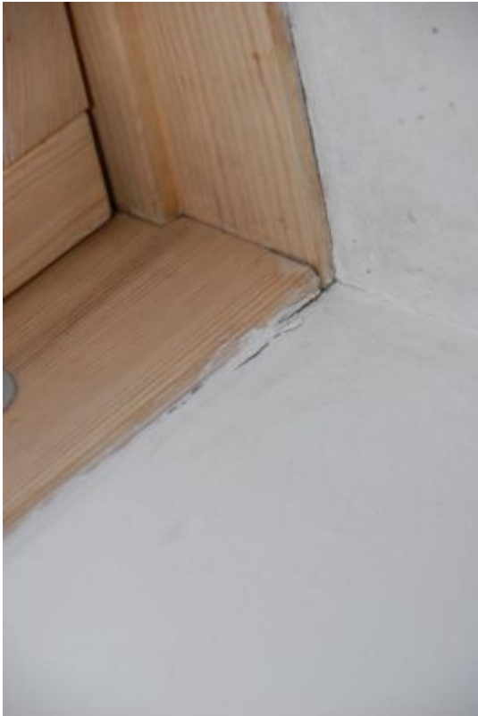
Abbildung 12: Zu geringe Fugenbreite am Fenster
