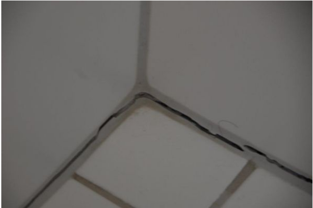
Abbildung 10: Kohäsionsrisse im Dichtstoff durch Estrichabsenkung
