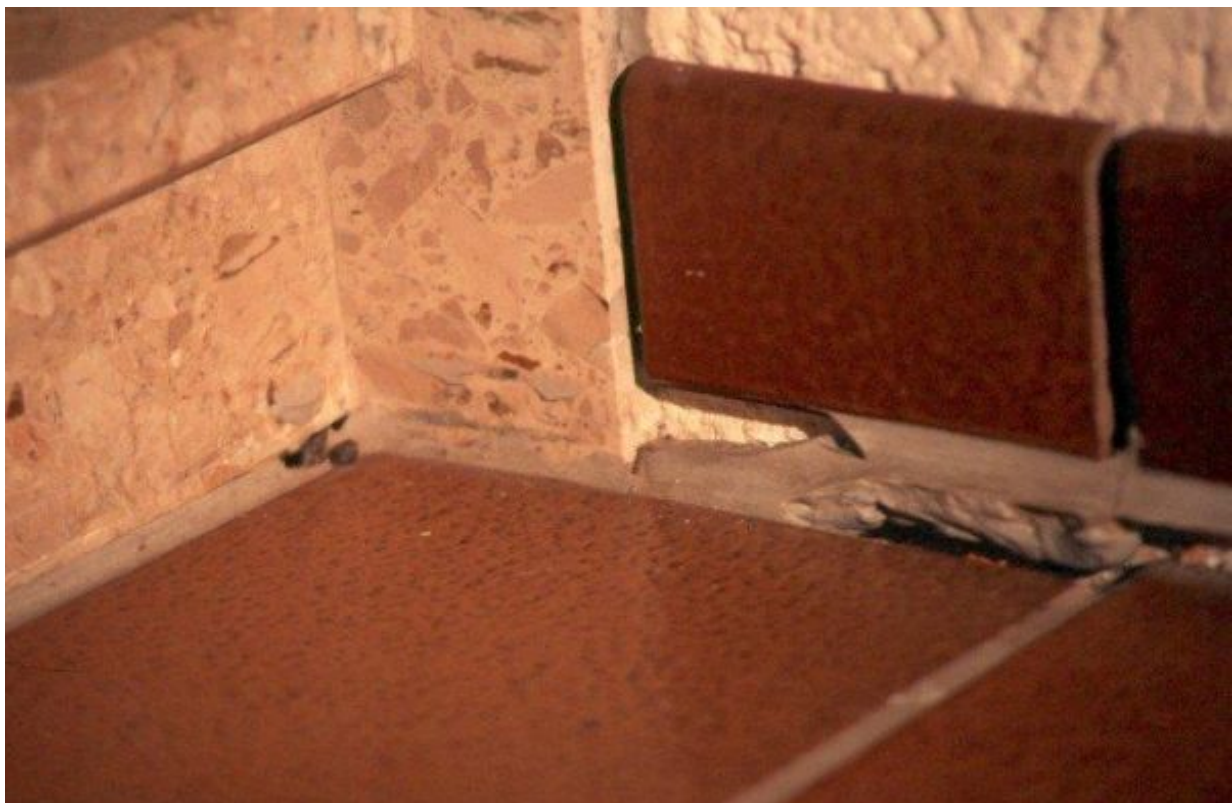
Abbildung 7: Zerstörung des Dichtstoffs durch Dreiflächenhaftung nach Bewegung
