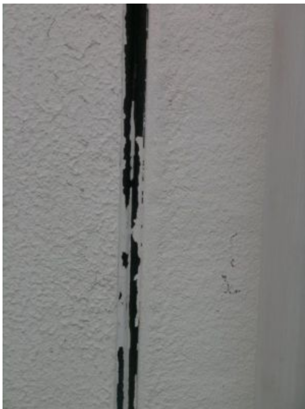
Abbildung 11: Unzulässiges überstreichen eines elastischen Dichtstoffs
