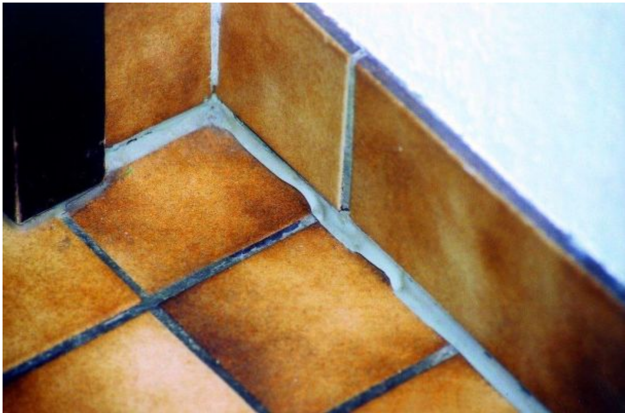
Abbildung 2: Haftverlust des Dichtstoffs an der Haftfläche
